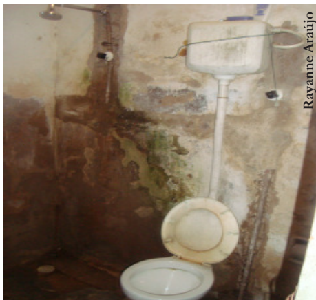
Banheiro de casa de moradora com vários problemas de infra-estrutura
